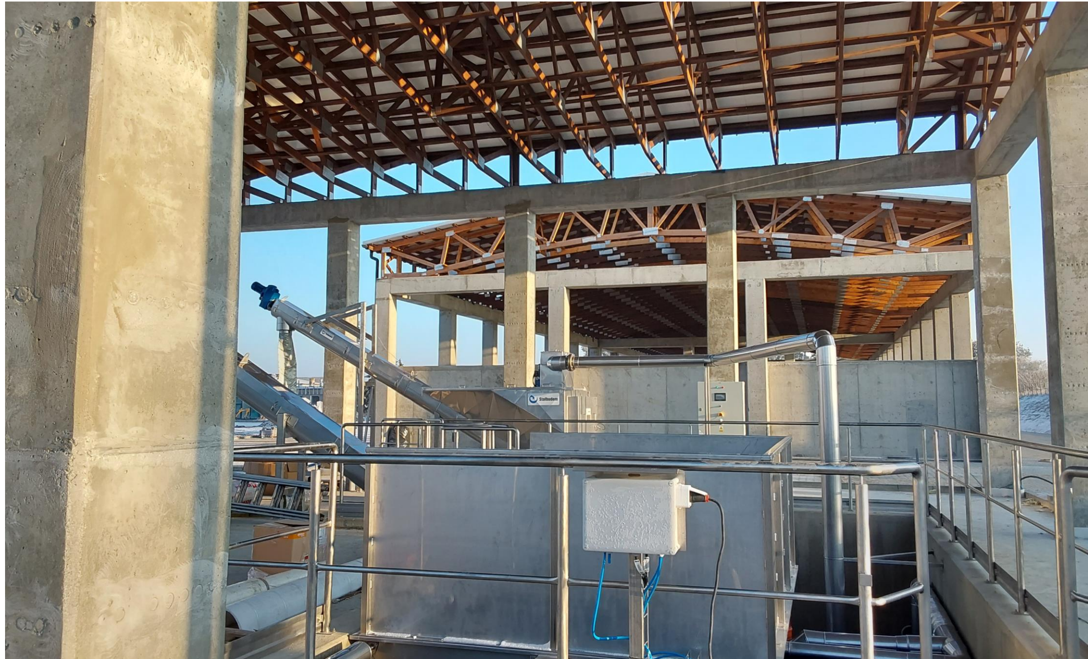
Stacja podczyszczania osadów z czyszczenia kanalizacji miejskiej po odbiorach końcowych
